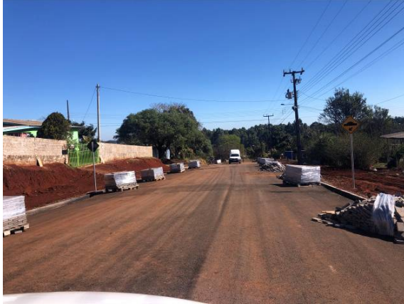
1 – Ondulação e sinalização vertical na Rua Goiás
