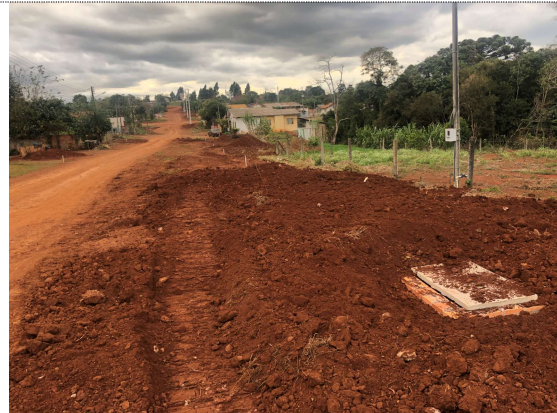
3- Boca de lobo na Pernambuco
